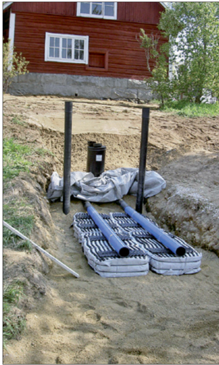
Maasuodatin in-drän moduuleilla. Ennen moduuleita on kolmiosainen saostuskaivo.
